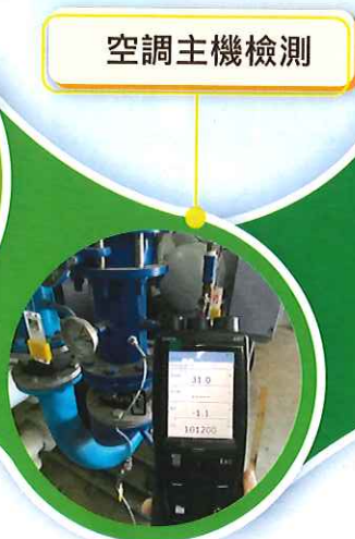
設備機房溫度檢測
