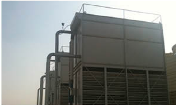
英格索兰空压机冷却项目 Ingersoll-Rand air compressor cooling project
