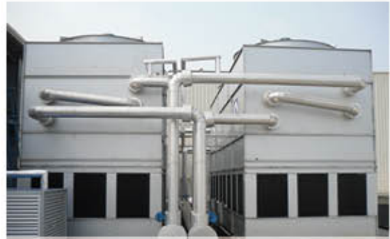
娃哈哈冷瓶机冷却项目 WaHaHa cold bottle cooling project
