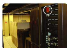
通信機房異常溫度偵測
