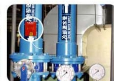
冰水機管路異常溫度偵測
