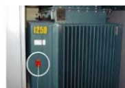
變壓器異常溫度偵測
