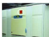
UPS 房溫度偵測
