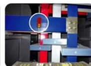
電力匯流排異常溫度偵測
