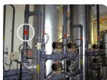
蒸汽管異常溫度偵測
