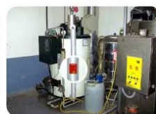
蒸汽管異常溫度偵測
