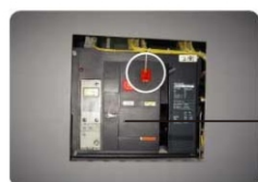
VCB過載異常溫度偵測
