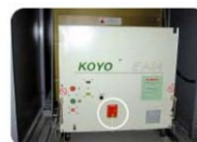
大型 UPS 異常溫度偵測
