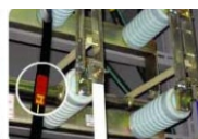
高壓大電纜異常溫度偵測
